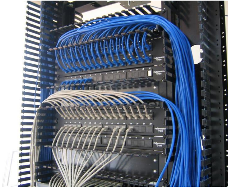
Figura 8. Aspecto del cableado estructurado.
