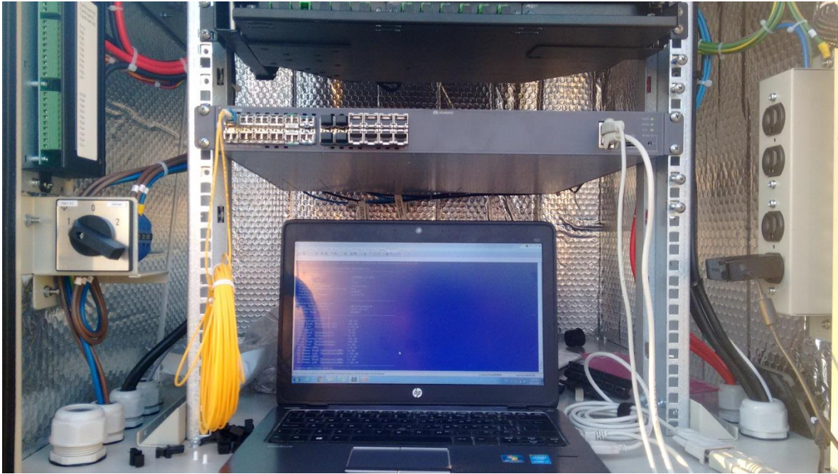
Figura 4.8.1 Configuración de equipos mediante hyperterminal conectado en modo consola.
