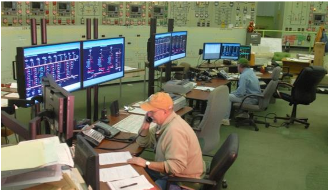
Operabilidad de SCADA.
