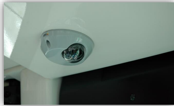
Figura 4.13 – cámara de video vigilancia.
