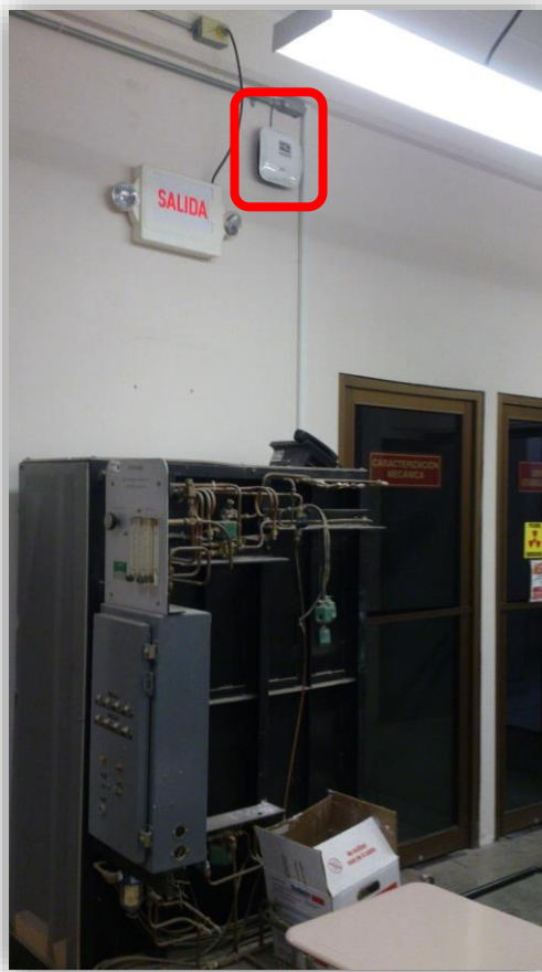
Figura 3.16 – AP en laboratorio edificio 8-B.
