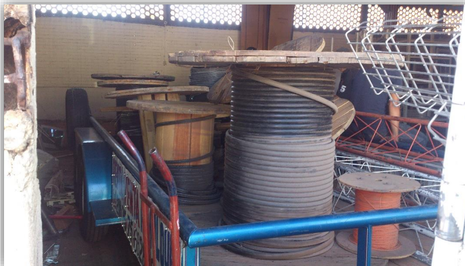
Figura 4.16 – Fibra óptica almacenada en bodega de tufesa.
