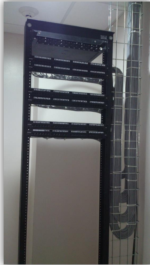
Figura 5.1 – Rack apegado a normas.
