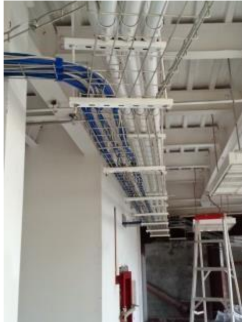
Figura 4.11 Escalerillas, cableado de Edificio
